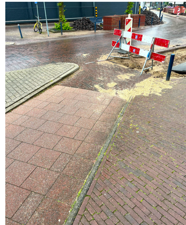
Werk in uitvoering op een deel van het fietspad waarbij te weinig ruimte is overgelaten voor bredere fietsen
